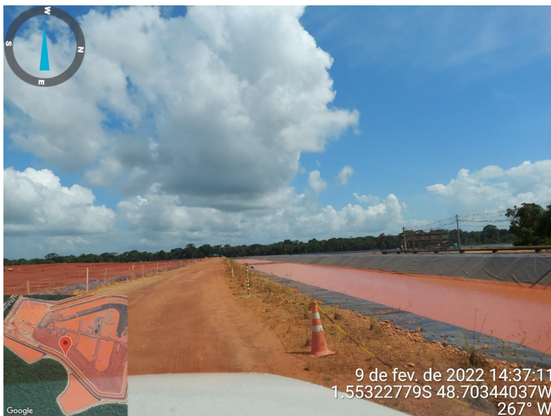
Figura 5.8 – Canal de contorno adjacente ao DRS2
