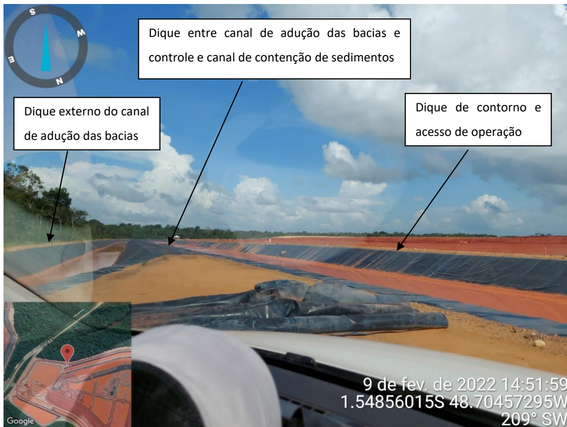
Figura 5.9 – Identificação do dique externo, dique entre canal de adução e canal de contenção de sedimentos e dique de contorno e acesso de operação.
