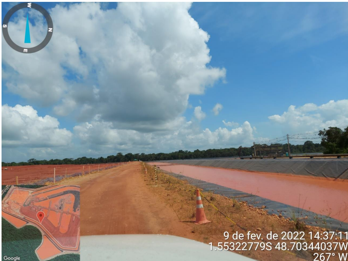
Figura 5.8 – Canal de contorno adjacente ao DRS2
