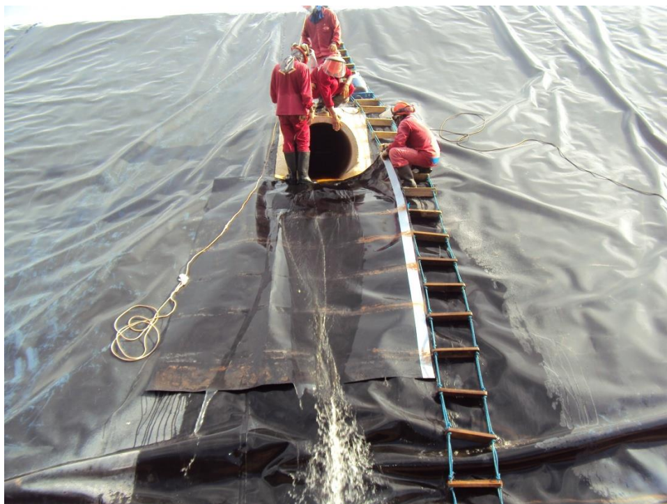
Figura 7.21 – CL1: Detalhe da manutenção devido ao comprometimento físico da geomembrana – parede leste
