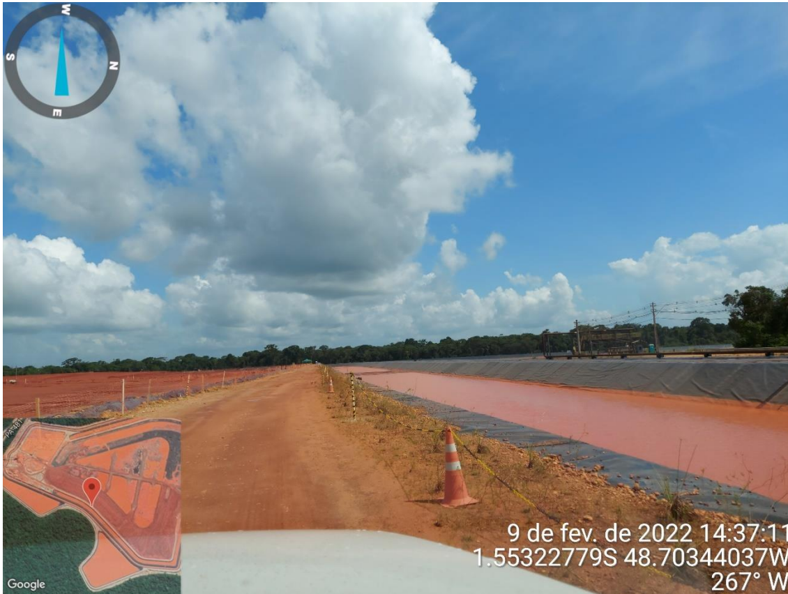
Figura 5.8 – Canal de contorno adjacente ao DRS2
